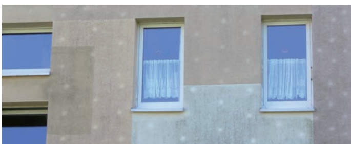
Les marques de tête de cheville dues à des erreurs d'installation ou au mauvais choix de cheville ne peuvent pas être éliminées de manière définitive.
